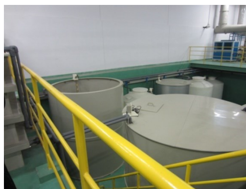
综合废水收集处理系统
