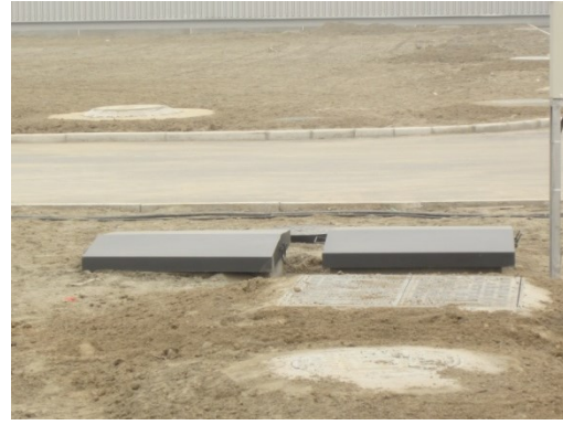
生活污水隔油池、化粪池
