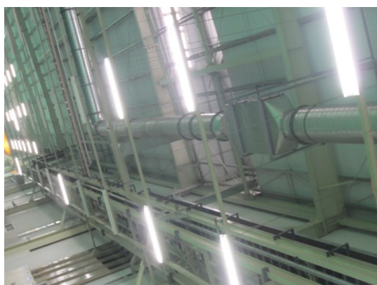
有机废气吸附过滤装置
